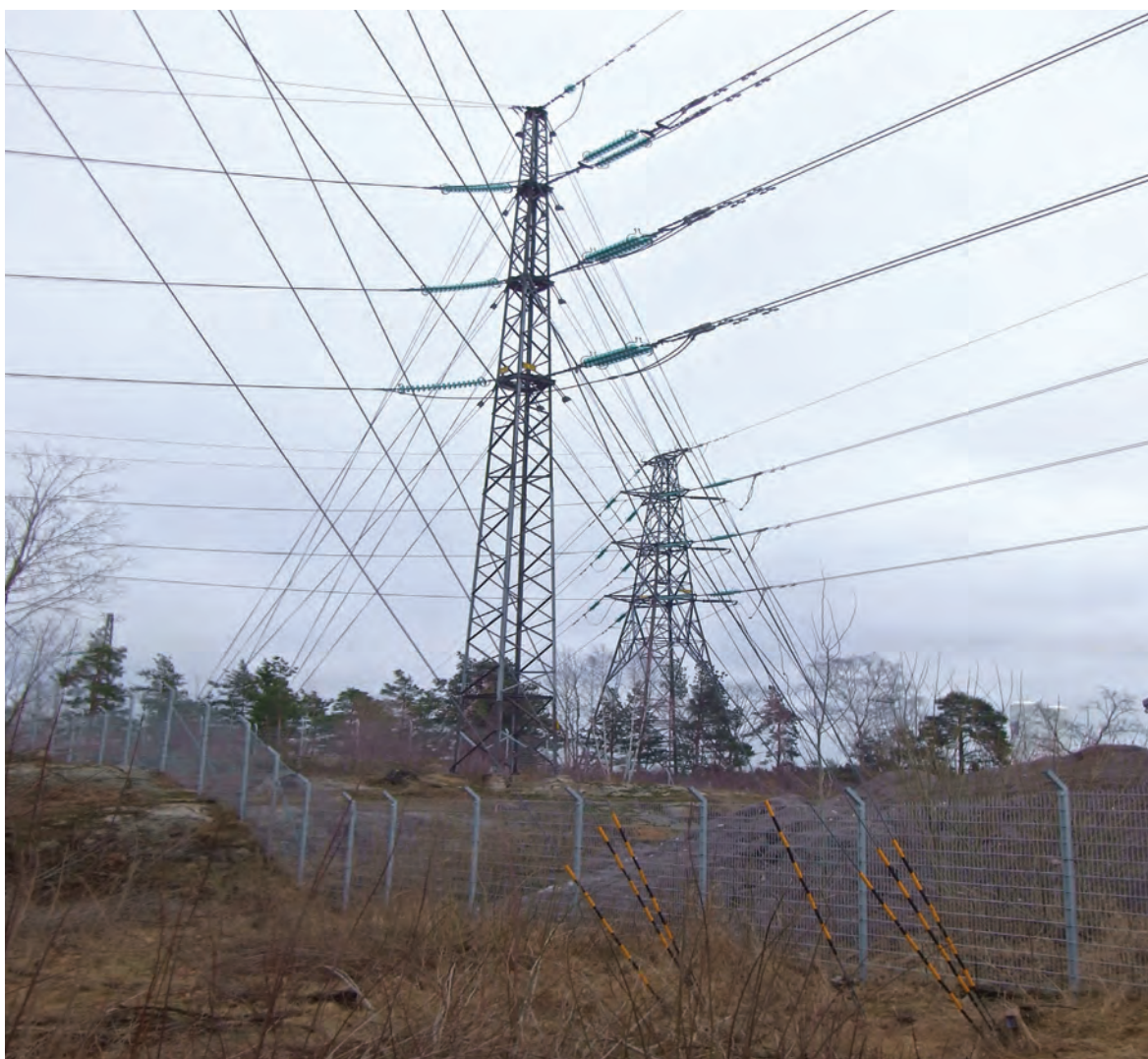
Figur 4.1. Befintlig stolpe med Nackaledningen t.h. och vinkelstolpe t.v. nordost om stationen i Högdalen.
