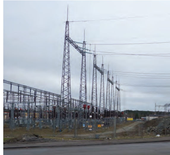
Figur 5.3. Befintliga ändstolpar vid stationen i Högdalen.
