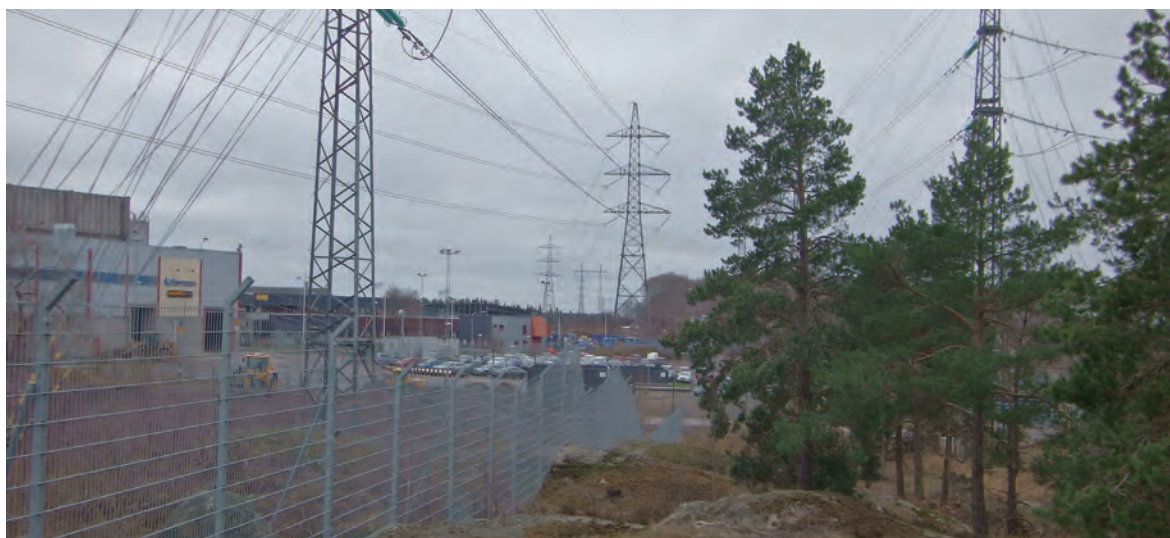
Figur 6.2. Befintliga kraftledningar vid Högdalenverket.
